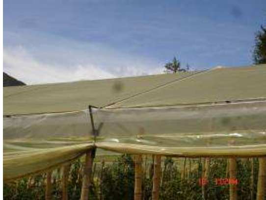
Figura 58. Acumulación de polvo sobre el plástico en un invernadero
