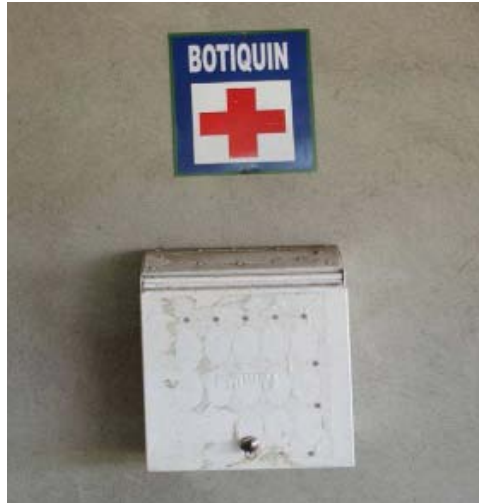
Figura 6. Botiquín para procedimientos de emergencias.
