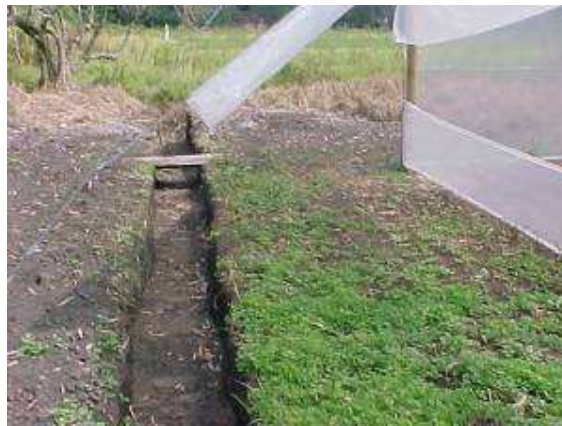
Figura 82. Drenajes en el exterior del invernadero para evitar excesos de humedad
