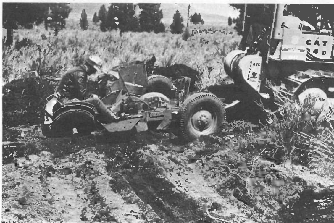
La plupart des planteuses mécaniques, telle que celle-ci utilisée aux Etats-Unis, sont étudiées pour planter des plants à racines nues. La mise au point de machines pour planter des plants en récipients est actuellement en cours. (Photo K.P. Karamchandani)
