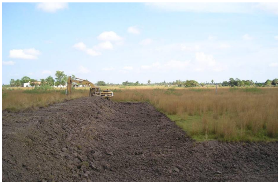
Foto Nº 9. Inicio de la excavación de un estanque piscícola. Nótese el suelo negro característico de alta presencia de materia orgánica.
