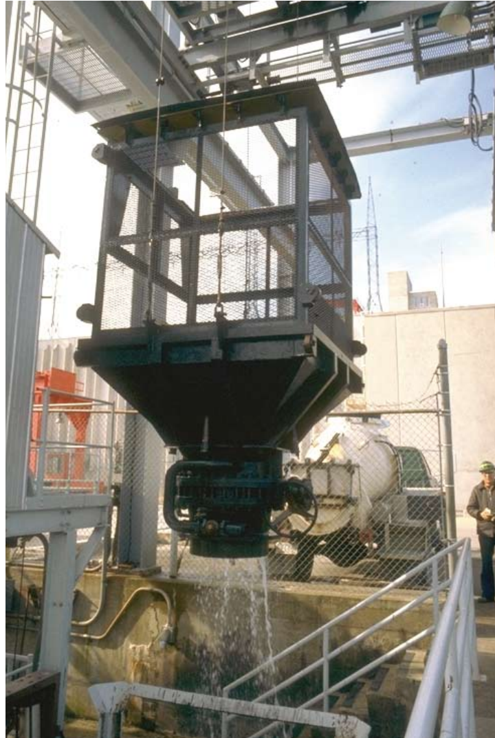
照片17：加拿大新不伦瑞克省圣约翰河麦克塔奎克大坝处的转运设施（Larinier摄）
