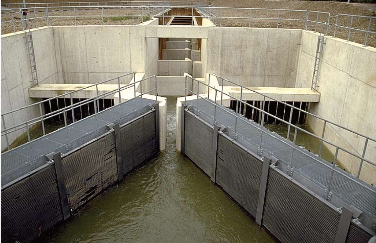
照片21: 通过伊费热伊姆鱼道（莱茵河）处的侧向滤网引进补充水，补充水流通过一种特制涡轮机从水池供应（鱼道流量为 1.2\text{米}^3/\text{秒} ，涡轮机流量为 12\text{米}^3/\text{秒} ）（Larinier摄）
