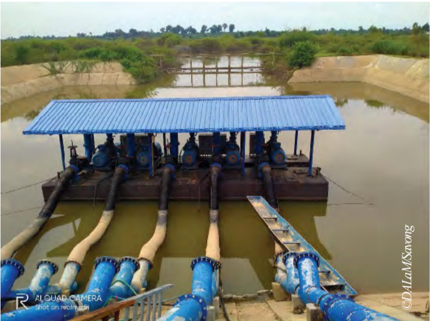
ເຄື່ອງຈັກປໍ່ນໍ້າຊົນລະປະທານ ໂດຍໃຊ້ໄຟຟ້າຢູ່ ເມືອງ ຫາດຊາຍຟອງ.
