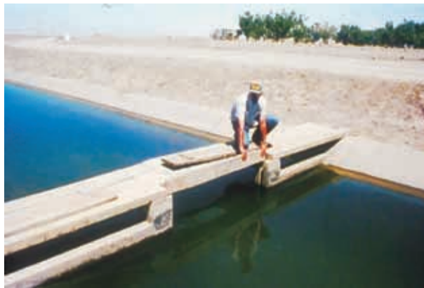
图6 装有闸板的闸门
