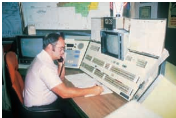
25 美国亚利桑那州，盐河项目：人工设置站点目标条件的 SCADA 主站
