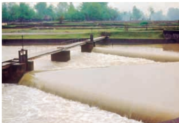
图 17 伊朗，吉兰项目：干渠上的双长顶溢流堰，容量为 100\text{m}^3/\text{s}
