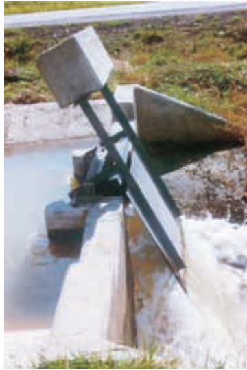
图 11 控制上游水位的自动翻板闸门
