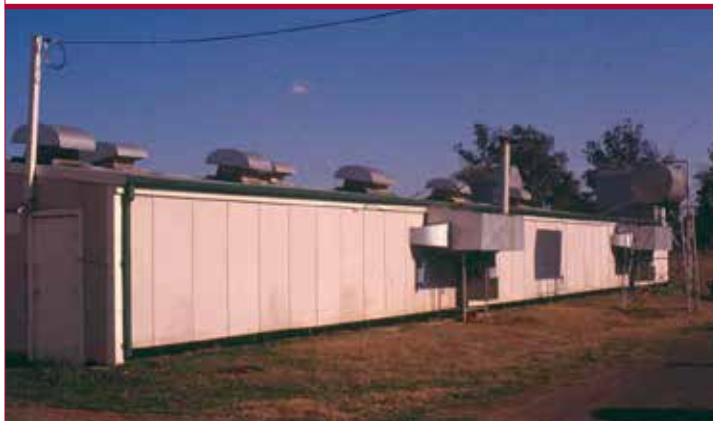
Criadoras de aire caliente a petróleo o a gas en el lado de la nave para la crianza a alojamiento completo: toda el área de cría se calienta a la temperatura requerida
