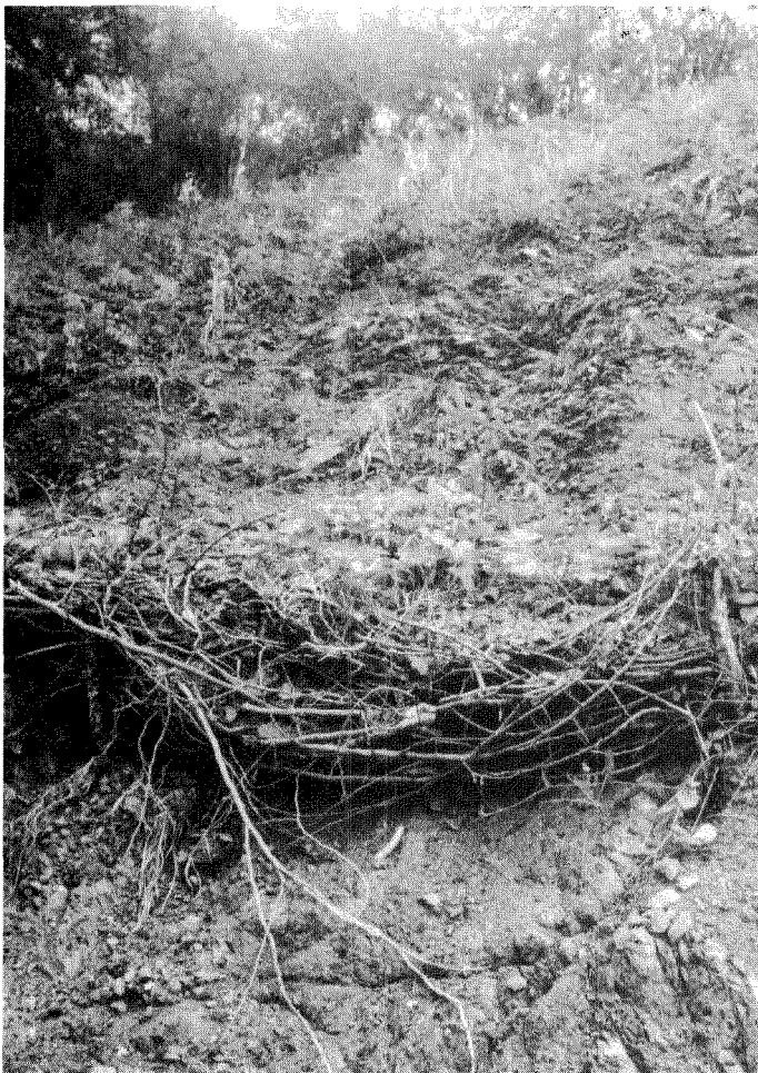
Rampe de paille affouillée à sa base (culture de manioc sur la berge à forte pente d'une ravine. Calumettes 1986)
