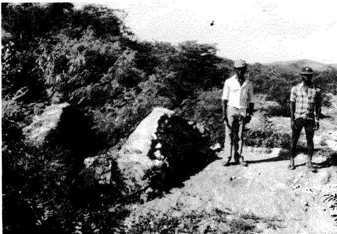
Le déversoir en dur du seuil a été contourné : la crue s'est ouvert un passage (à l'emplacement des deux techniciens) à travers l'aile du seuil, construite en terre compactée (Ravine de Neg Marron 1986)
