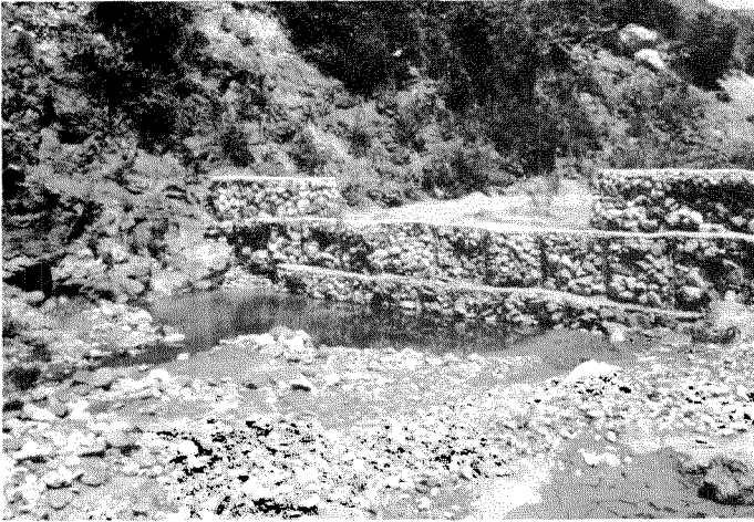
Seuil de correction torrentielle vu de l'aval, avec une dépression remplie d'eau créée par l'affouillement (ravine de Sedren 1986)
