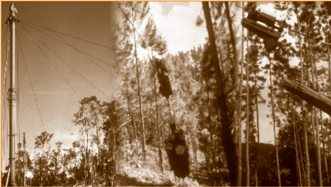
Fotos 6.10 Sistema de extracción con cables
