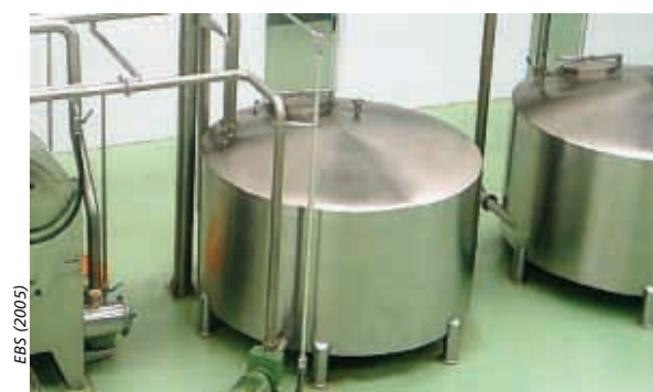
Lámina 33 Tanque pulmón o de bombeo
