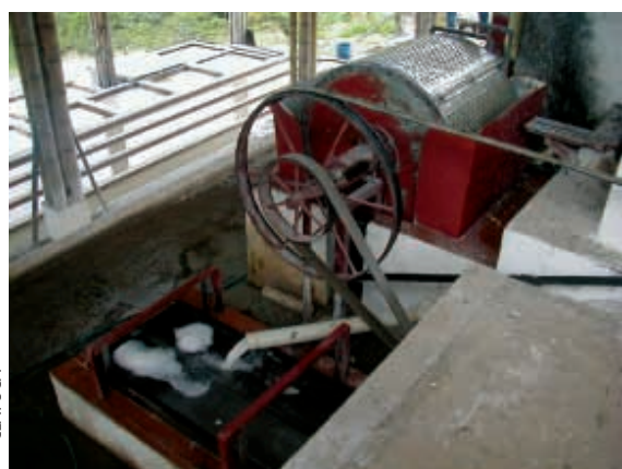
Lámina 22 Coladora y tamiz vibratorio
