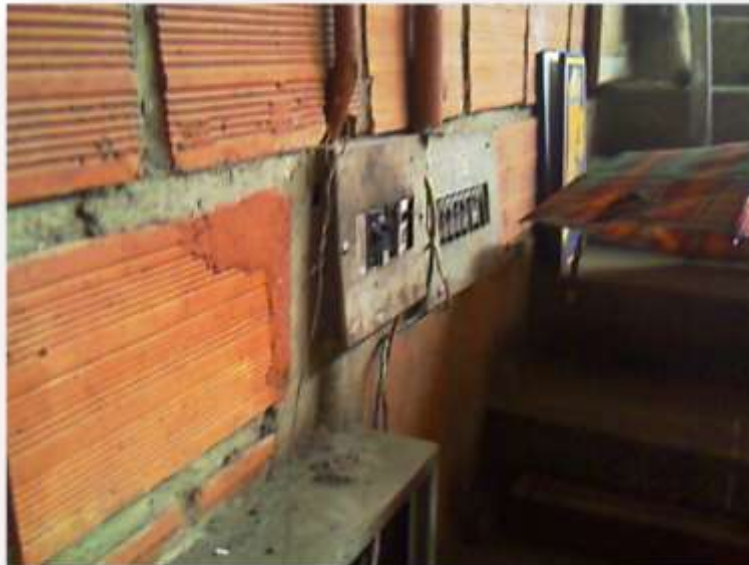
Foto 6 Instalaciones eléctricas en la plaza de mercado
