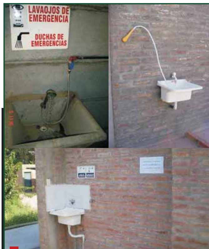
Foto 4.86. Distintos sistemas para la instalación de lava ojos en campo. Fotos: R. Espindola
