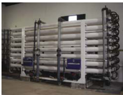
Figure 1. Usine de traitement par osmose inverse assurant le dessalement de 2 500 m 3 /jour d'eau saumâtre souterraine en Espagne (technologie membranaire)
