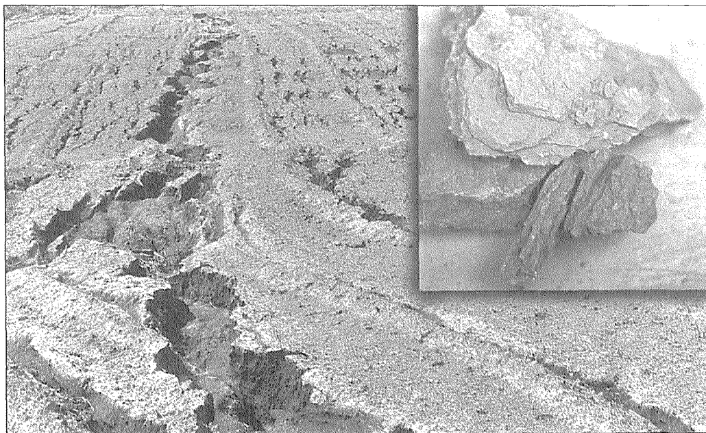
FIGURA 15: Suelo labrado con rotavator, muy afectado por la erosión, pulverizado en la superficie y con problemas de compactación en la capa subyacente (ver detalle), en Tierra Blanca de Cartago.
