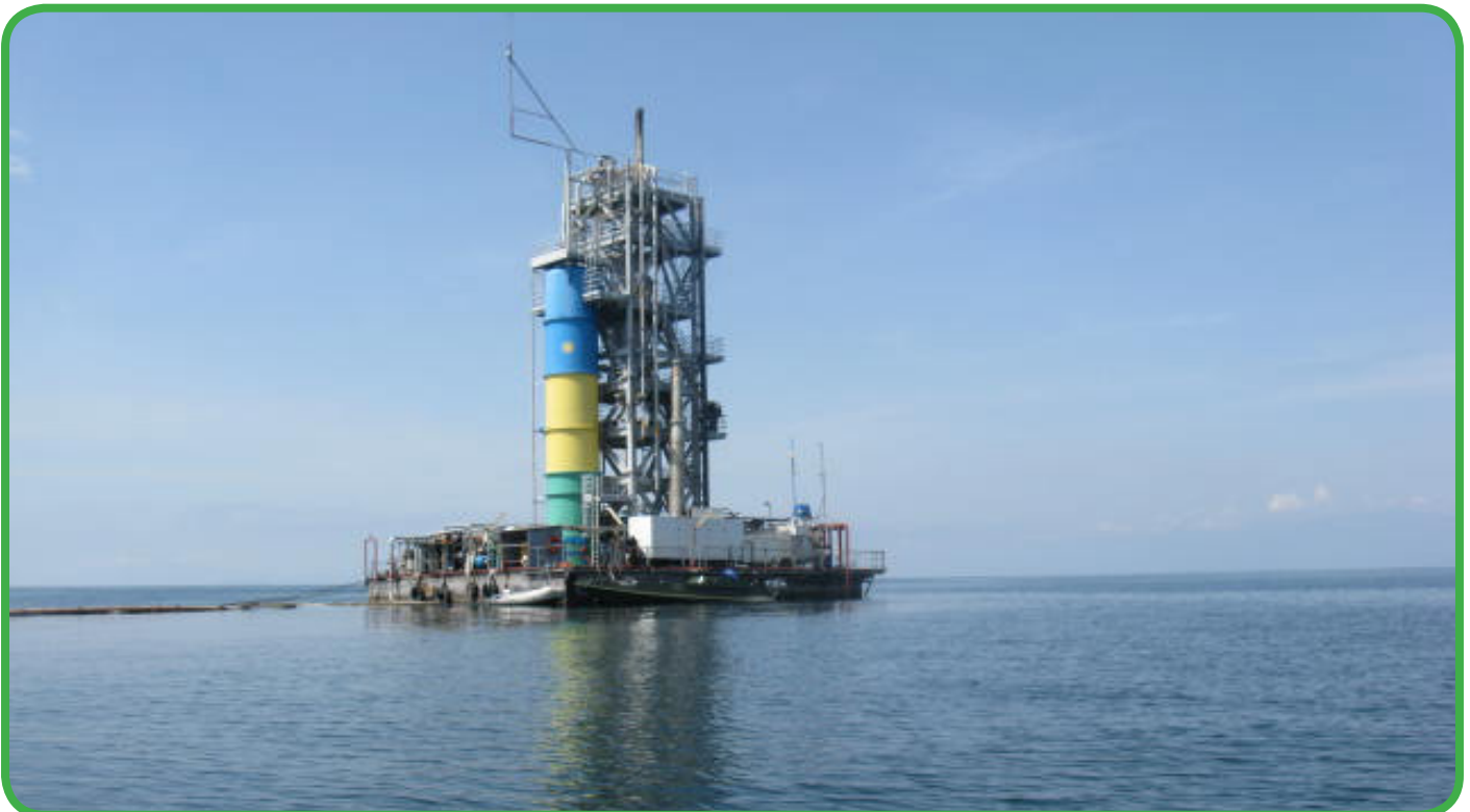
Une installation flottante sur Lac Kivu pour pomper le gaz méthane. Photo par Faustin Gashakamba/ARCOS
