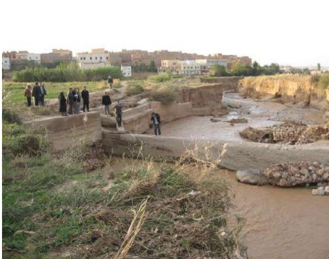
Dégâts au niveau de l'infrastructure de base causée par les inondations (2008)
