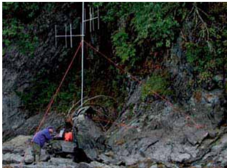
FIGURE 7.9 Antennes Yagi montées sur une tour à une station de suivi à distance attachée à un enregistreur de données
